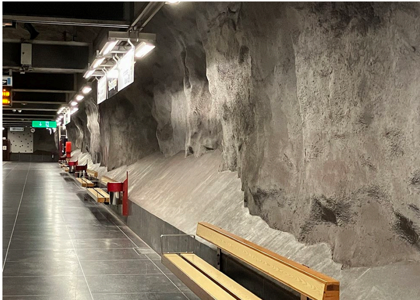
Figur 4-4 Bergutfallet tydliggörs mot sockelns geometri, station Stadshagen.
